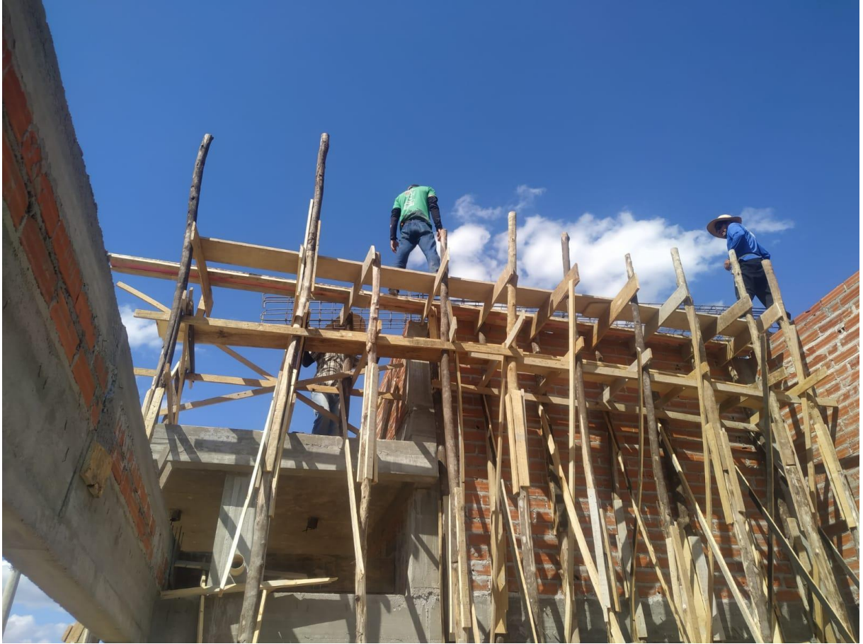
Figura 08: Trabalho em altura sem EPI correspondente e com alto risco de queda. Fonte: Própria, 2022.
