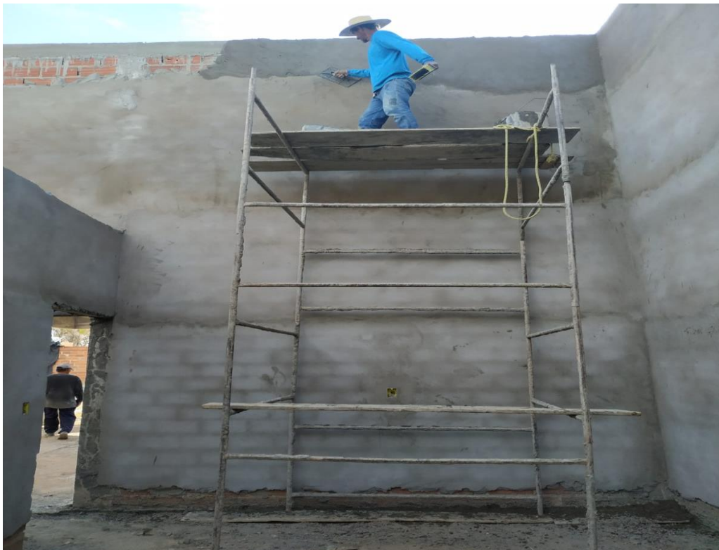
Figura 03: Não uso de EPI em altura causando risco de acidente ao colaborador. Fonte: Própria, 2022.
