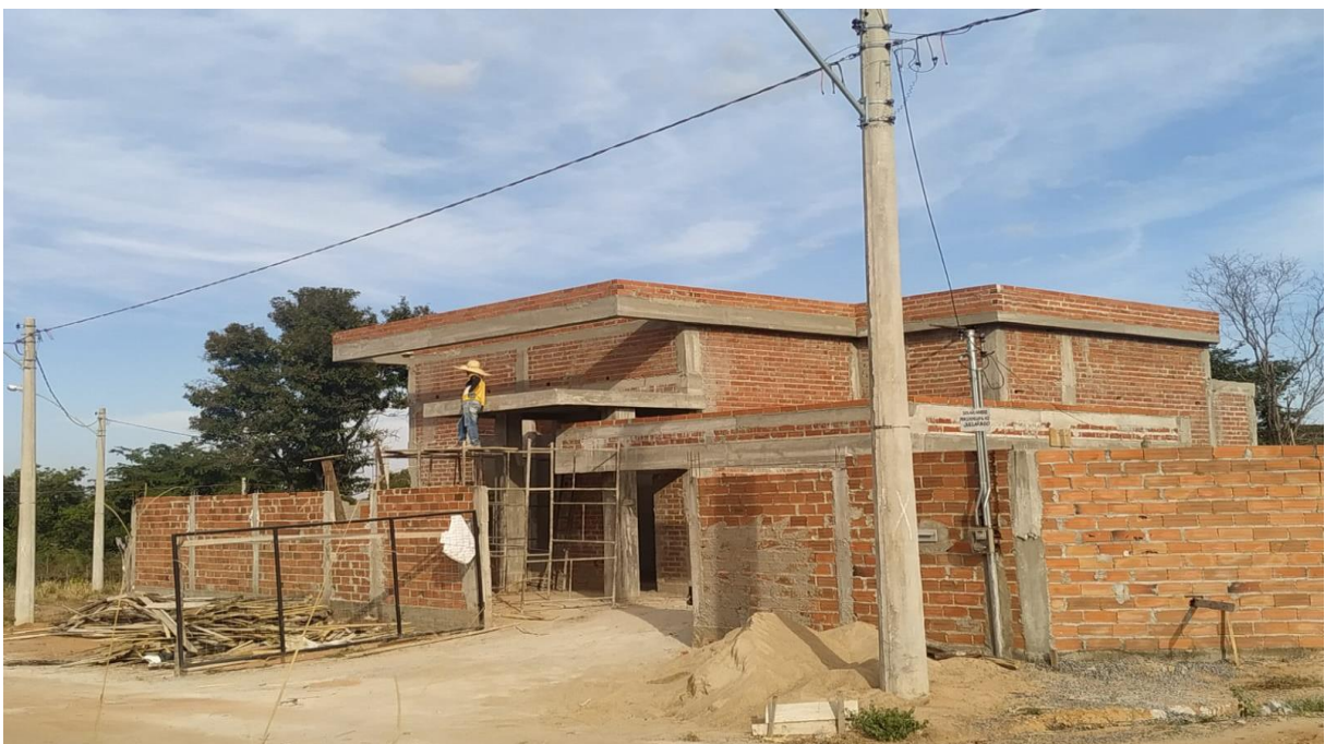
Figura 07: Colaborador em altura e sem EPI adequado. Fonte: Própria, 2022.
