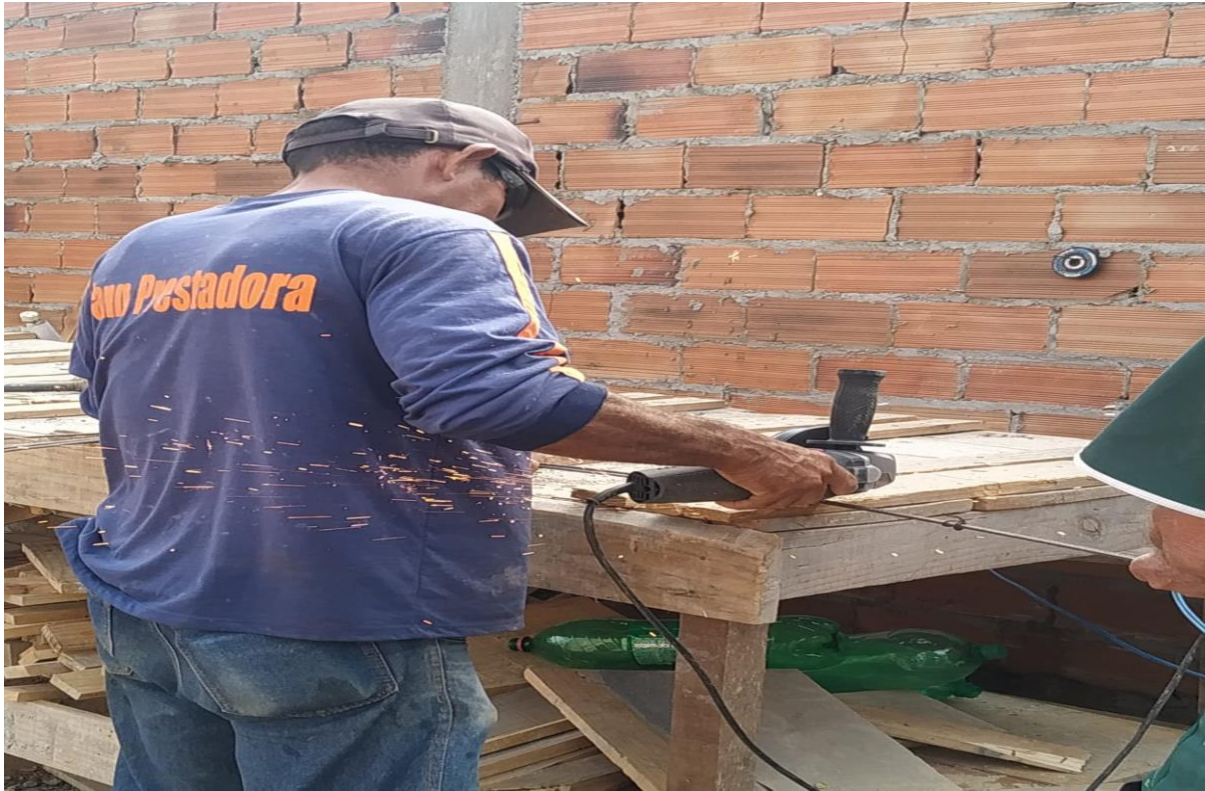
Figura 04: Uso de ferramenta cortante e sem o uso de EPI pelo colaborador. Fonte própria, 2022.
