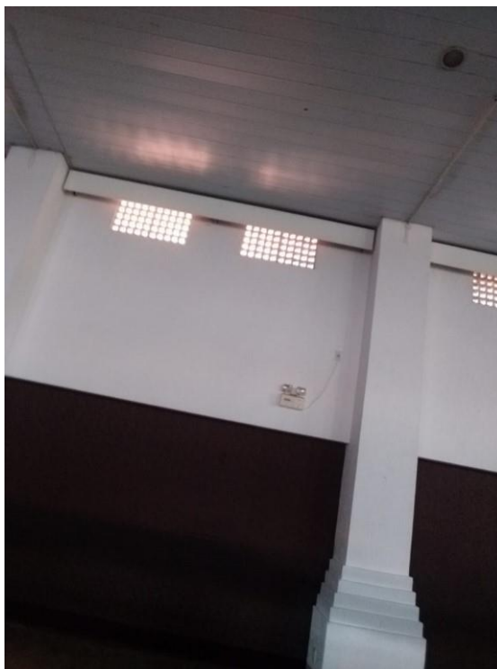
Figura 4 – Iluminação de Emergência ( Fonte: Autoria própria, 2021)
