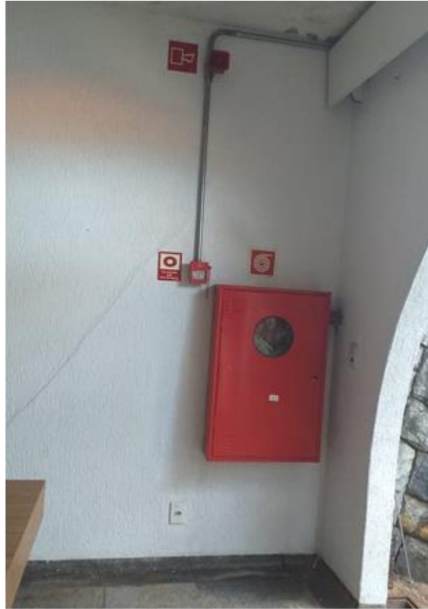
Figura 7 – Hidrante (Fonte: Autoria própria, 2021)
