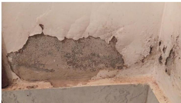
Figura 5 - Descascamento da pintura por falta de impermeabilização Fonte: própria, 2021.
