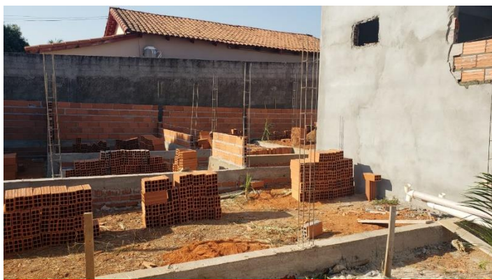
Figura 2 - Obra que não optou por impermeabilizar a viga baldrame Fonte: Própria, 2021
